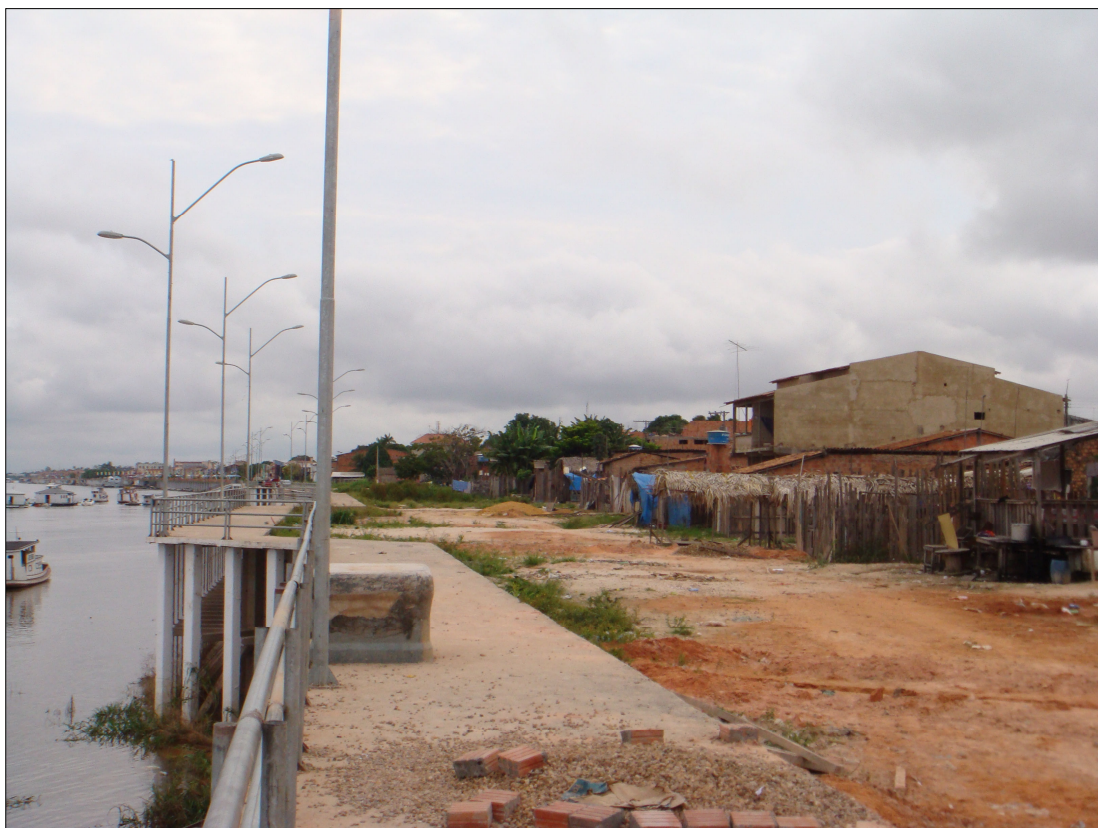
FOTO 20 – OBRAS INACABADAS NA ORLA DA MARABÁ PIONEIRA (CABELO SECO): no bairro Francisco Coelho, o popular Cabelo Seco, espaço onde a cidade surgiu, a estrutura atual do calçadão da orla se encontra inacabada e, por isso, tem causado muito transtorno aos moradores (Foto: Michel Lima, janeiro de 2010).
